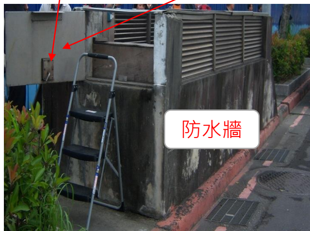
出入口架高防淹水
