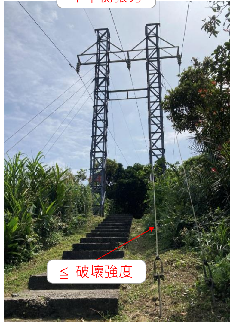
輸電鐵柱不平衡張力之抗拉支線
