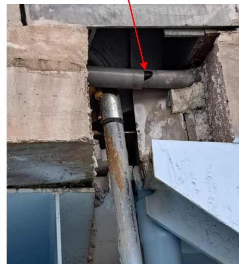
1130403地震 造成管路受損
