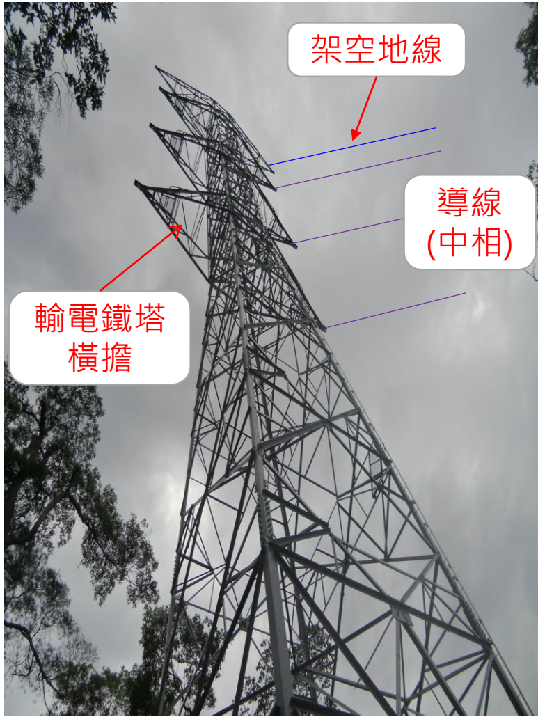
輸電線路鐵塔
