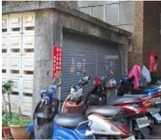
地下配電初期採用磚造配電場所，放置開關及變壓器。
