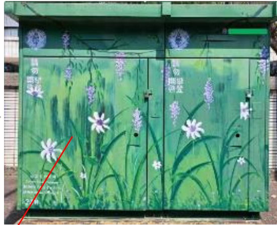
裝甲開關箱 裝設裸露開關，體積大， 維護困難。
