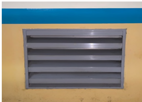
變電室通風口防火閘板
