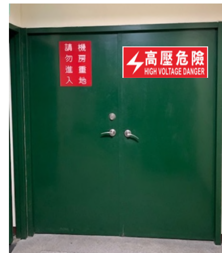
變電室警告標識
