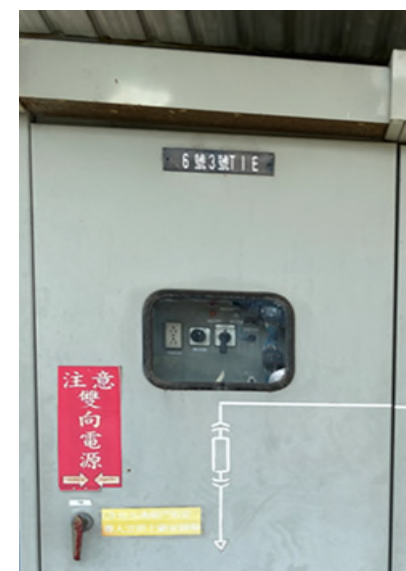
雙向電源警告標識
