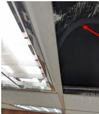
天花板內燈具電源導線須裝設於導線管內
