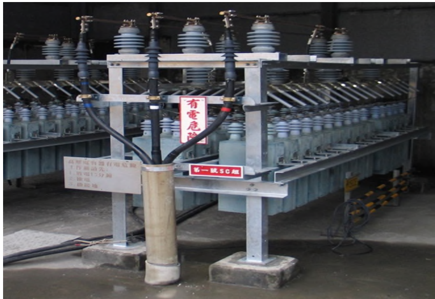
高壓電容器外殼接地
