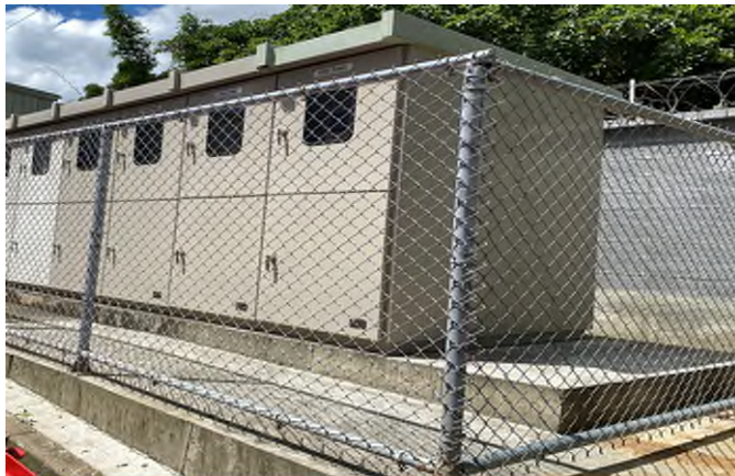
帶電部分裝設於上鎖之封閉箱體
