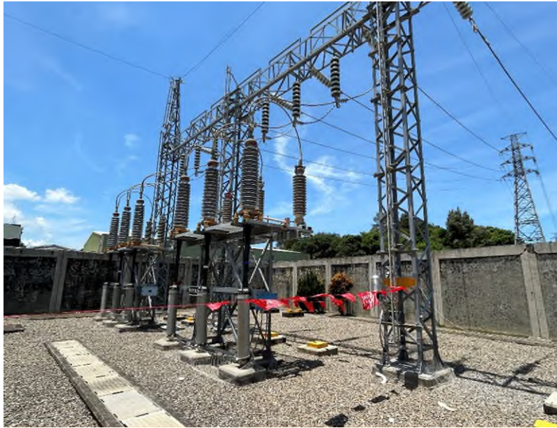
裸銅線裝設於合格人員可觸及處
