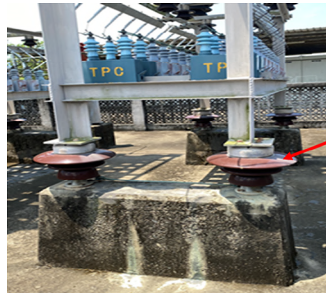
高壓電容器外殼不接地
